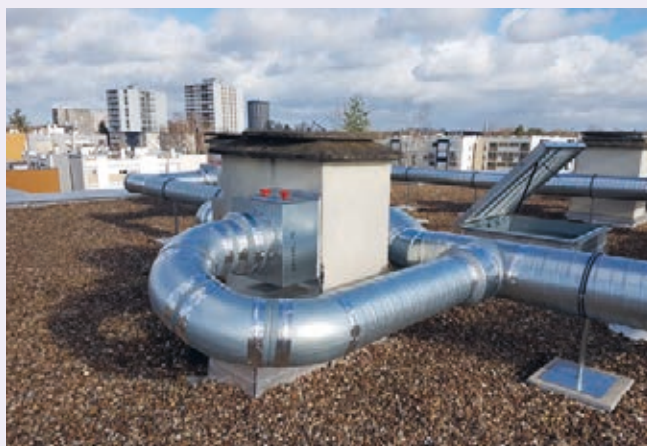
PLM_PS en toiture terrasse
